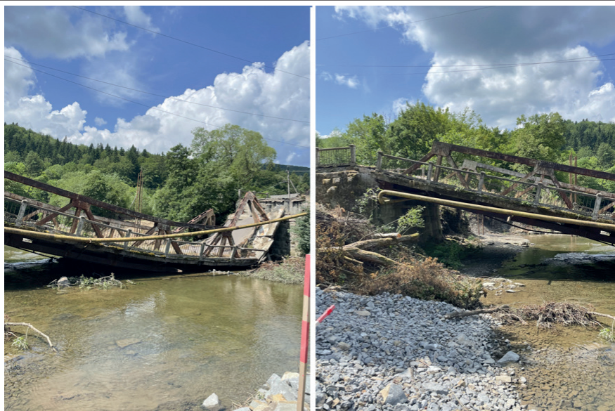
Рис. 4. Обвал мосту у с. Жденієво (фото автора)
